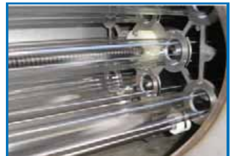
Un traitement tertiaire par UV permet le respect des normes en matière de bactériologie.
