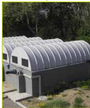
Station en Nouvelle Calédonie pour le quartier résidentiel de Bahia : décanteur - digesteur - biodisques et tambour filtrant
