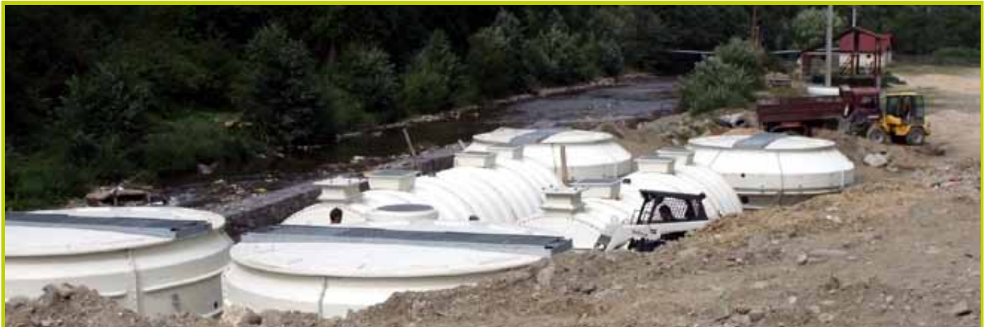
La station est entièrement réalisée en polyester. Un bâtiment traditionnel reçoit les équipements périphériques.
