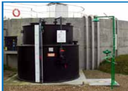
La station comprend les équipements de nitrification-dénitrification et déphosphatation.
